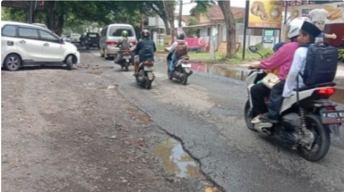
(Kondisi ruas Jalan Kepiting Kelurahan Tukangkayu, Banyuwangi)
